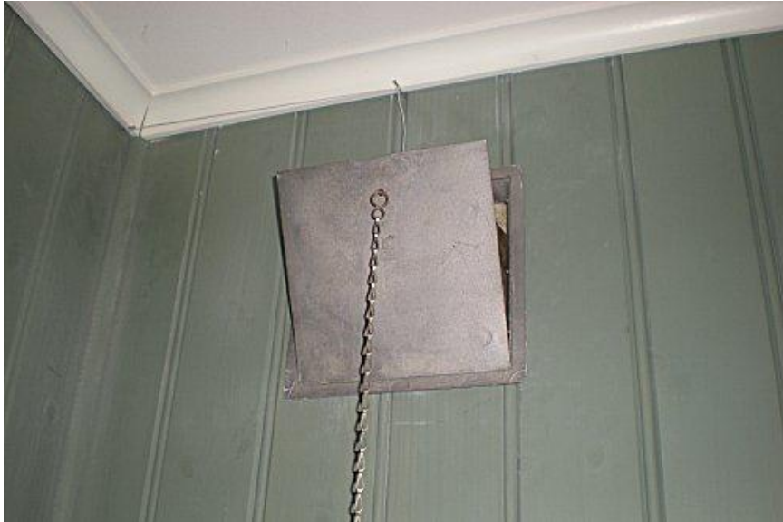
Figur 1 Klaffventil i yttervägg.
